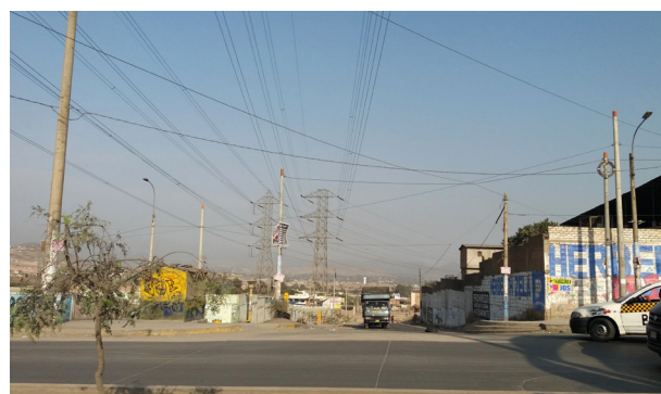
Línea de alta tensión en Lima, fuente de la imagen: Christian León
